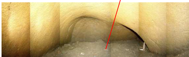
図 空洞検出事例
