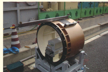
Sリードを搭載した外殻管に初期方位設定用の治具を取り付けます。
