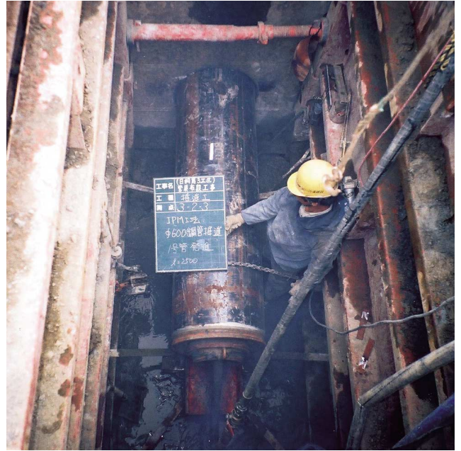
開削工途中の、河川横断や国道横断でも、簡易土留めから発進できます。
