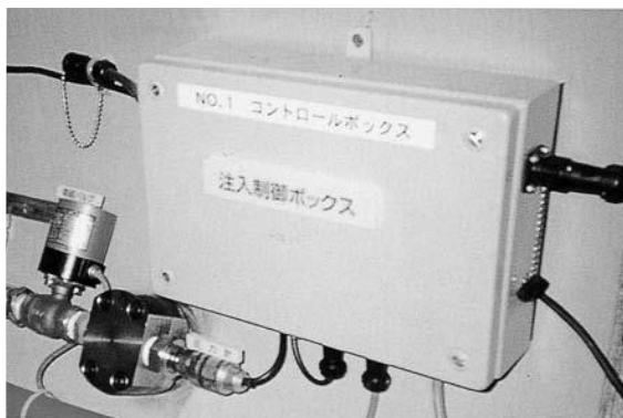
坑内注入制御盤
