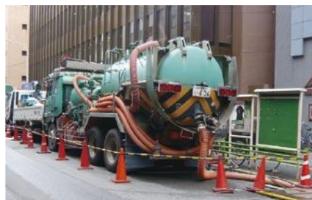
バキューム車直接吸引
