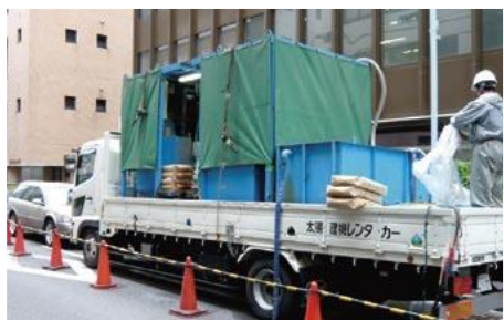
送泥・2液性固結滑材プラント（先頭）
