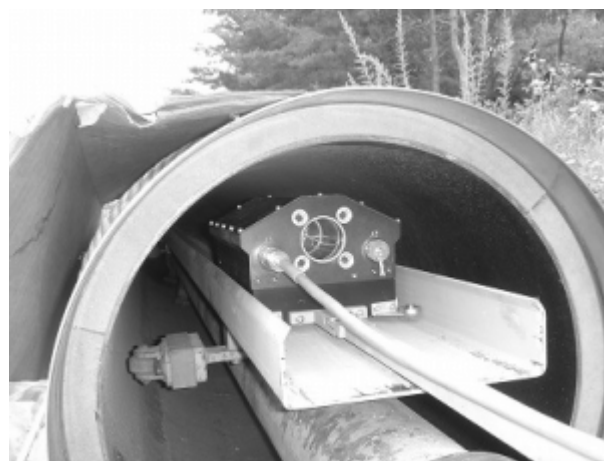
写真 2.4-2 管内配置状況
